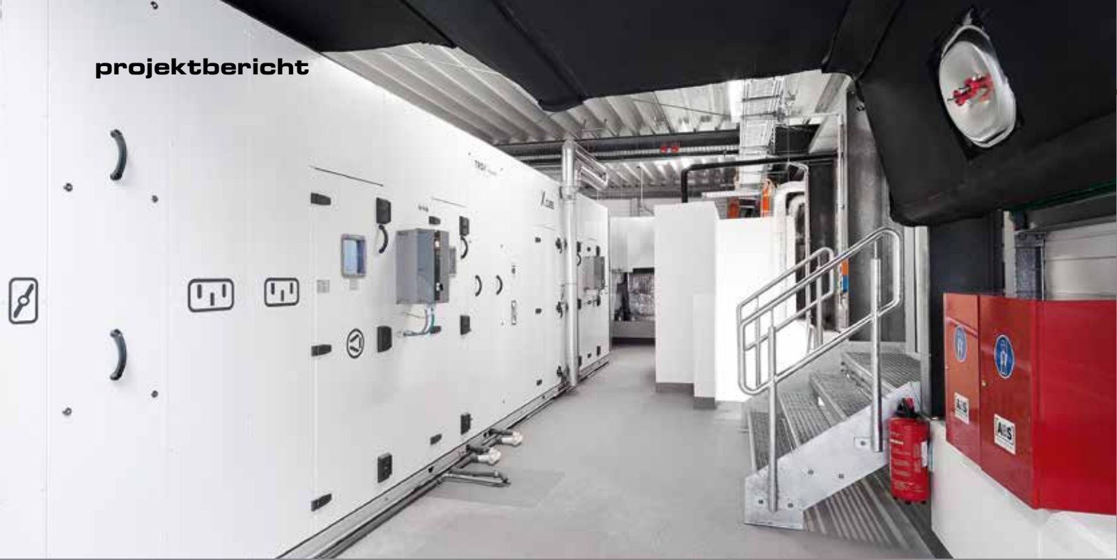
X-CUBE RLT-Gerät mit einer Luftvolumenstromleistung von insgesamt 22.000 m 3 /h. Über das X-CUBE control Display können unterschiedliche Parameter abgerufen werden.
